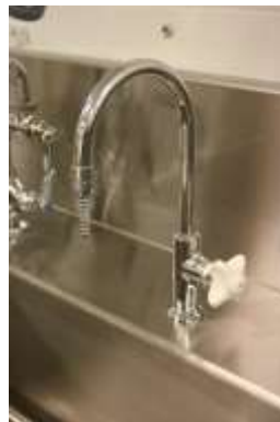
DI and RO water Faucets
